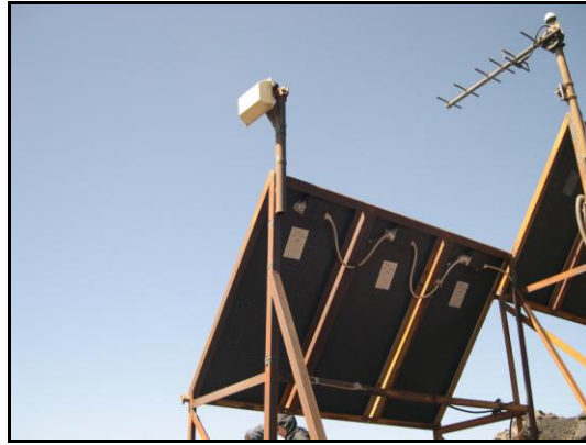
Figura 3: Sistema di alimentazione delle stazioni installate presso il Belvedere.
