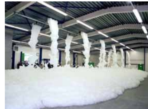
Impianto a schiuma
