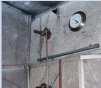
Impianto di ventilazione in fibrocemento
