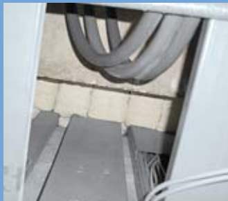
Barriera antifiama con cuscini di amianto
