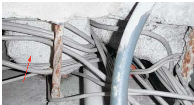
Barriere antifiamma contenenti amianto
