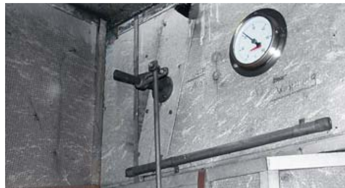
Canale di ventilazione in pannelli di fibrocemento
