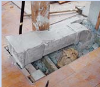
Canale di ventilazione in fibrocemento
