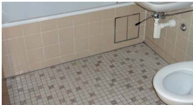
Piastrelle per pavimenti e pareti con colla contenente amianto
