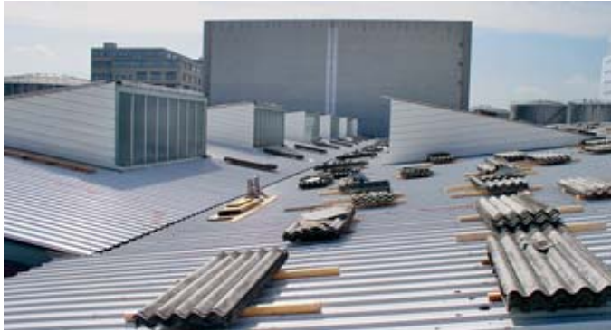
Lastre ondulate contenenti amianto
