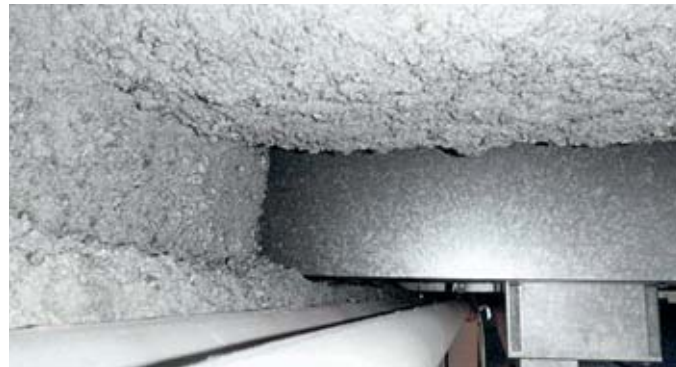
Amianto spruzzato come rivestimento antincendio su travi di acciaio
