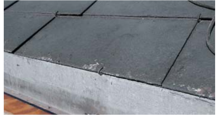
Pannelli di ardesia contenenti amianto
