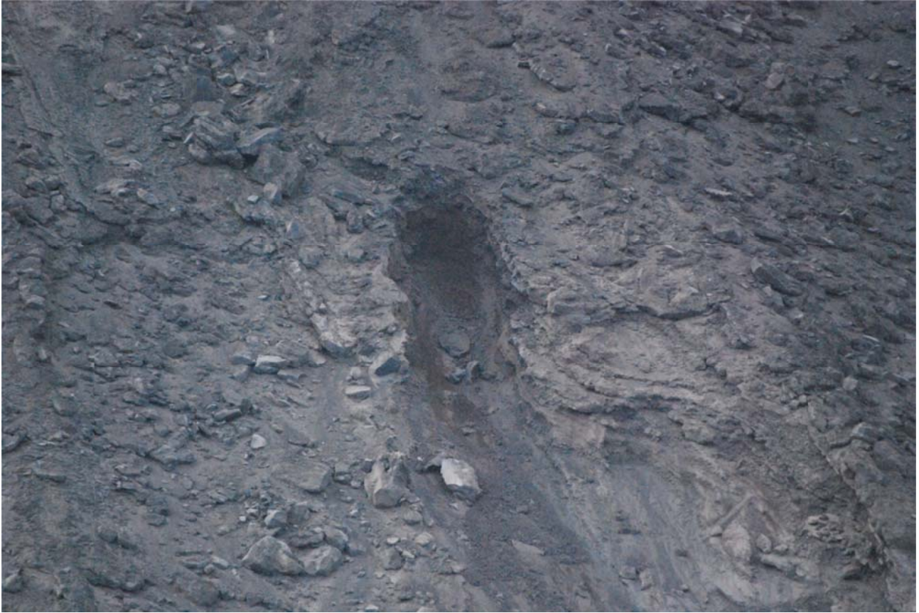
Fig. 2. Dettaglio della nicchia di distacco, che mostra la sua geometria e le caratteristiche litologiche del materiale coinvolto nella frana (diversi strati di materiale piroclastico e/o epiclastico ricoperti, al tetto, da una sottile colata di lava). Si nota la presenza di blocchi lavici plurimetrici nel materiale franato.
