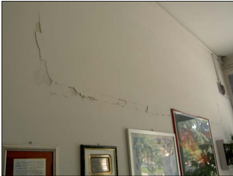
Fig. 2. Nicolosi: lesioni agli intonaci di un edificio in c.a.
